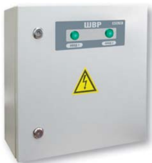
Шкафы ввода резерва
